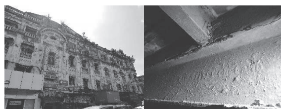
写真26 Futnani Chambers 写真27 天井梁(Cargo Fleet)
